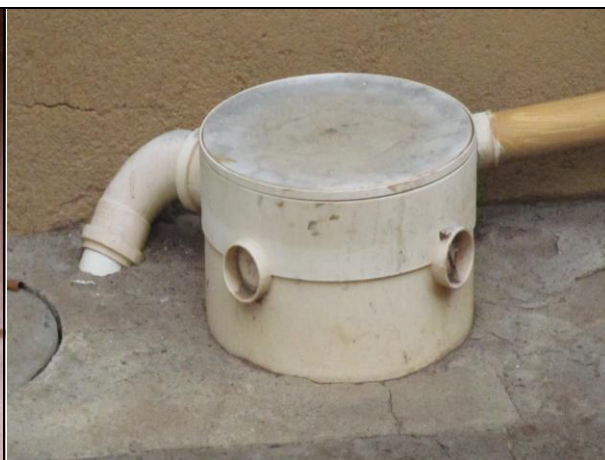
FOTO 02 – Caixa de Gordura
